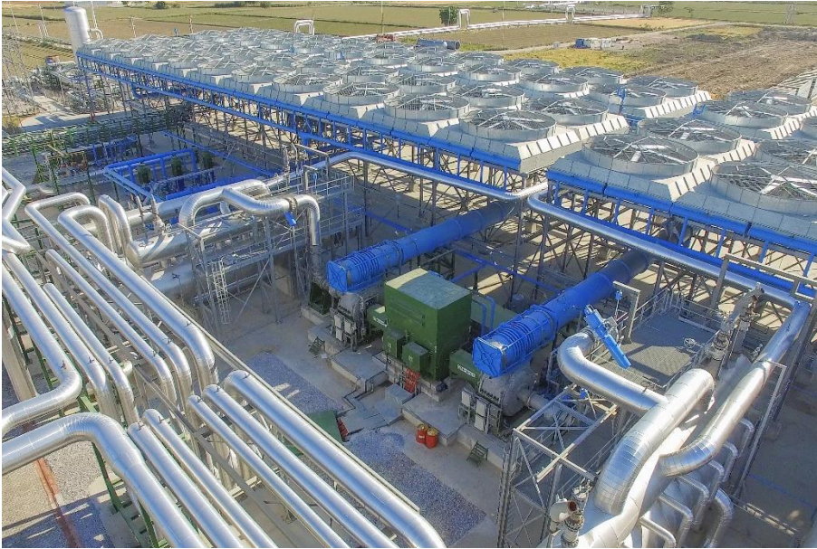
Centrale geotermica da 24 MWe con tecnologia Exergy a Germencik, Turchia
