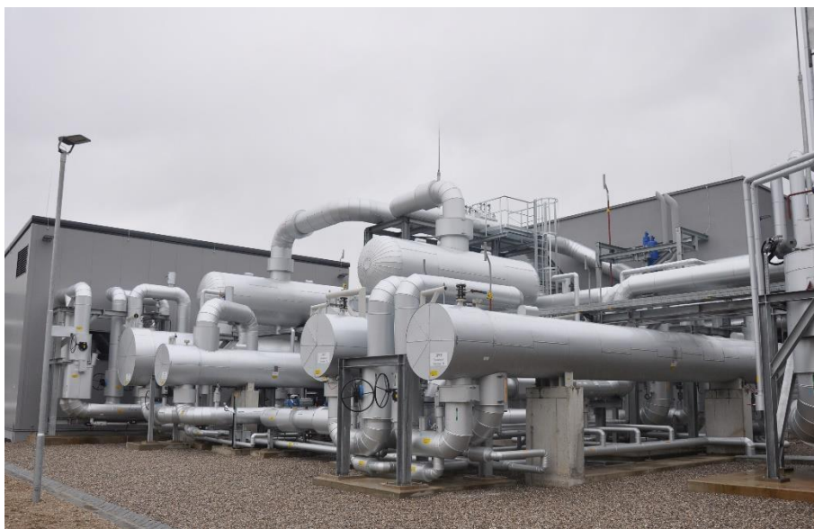
Impianto geotermico, Garching a.d. Alz, Germania - Strabag
